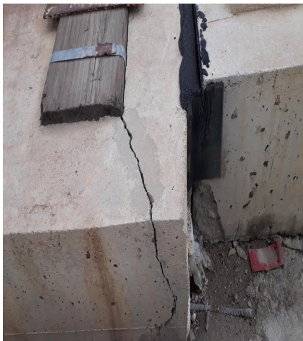
شکل ۳- نمونه خرابی های موجود در خط یک قطارشهری
