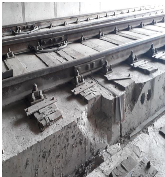
شکل ۲- نمونه خرابی های موجود در خط یک قطارشهری
